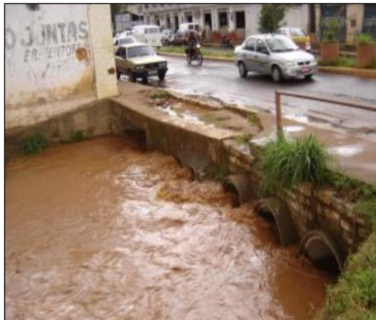
Figura 14 – Anilhas de concreto
