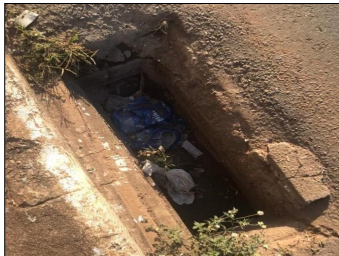
Foto 3 – Boca de lobo 1
